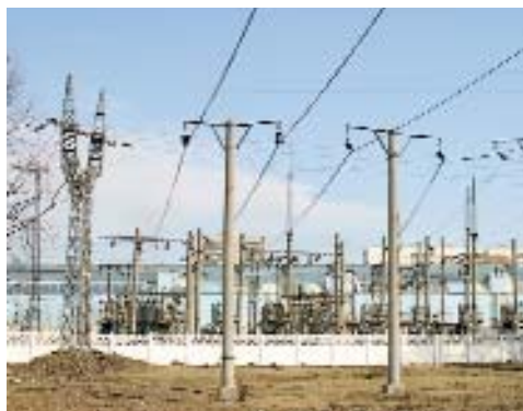
Тяговая подстанция на Экспериментальном кольце
